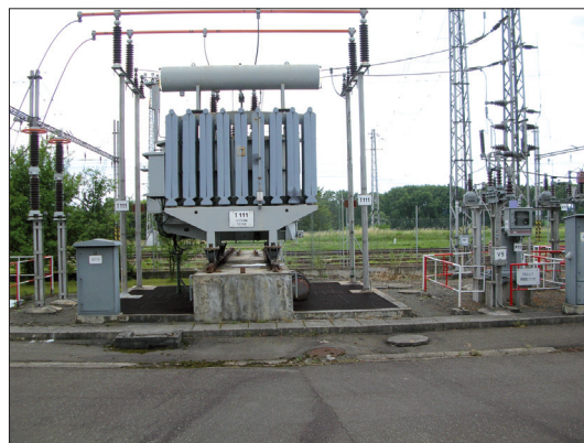
Obr. 4. Napájecí stanice pro proudovou soustavu AC 25 kV
