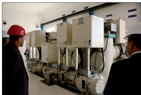
Obr. 2. Nová zapouzdřená rozvodna v Moravanech u Brna dodaná společností Siemens na klíč distribuční společnosti E.ON
