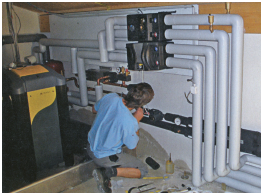
Obr. 4. Tepelná izolace rozvodného potrubí tepelného čerpadla
