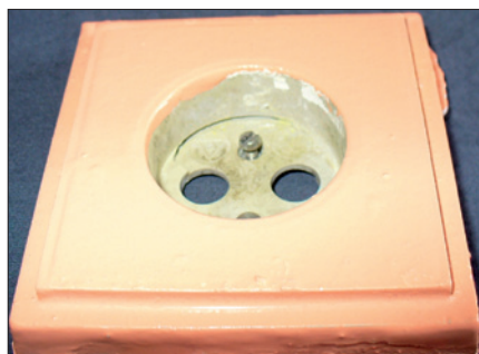
Obr. 2. Poškodený kryt zásuvky
