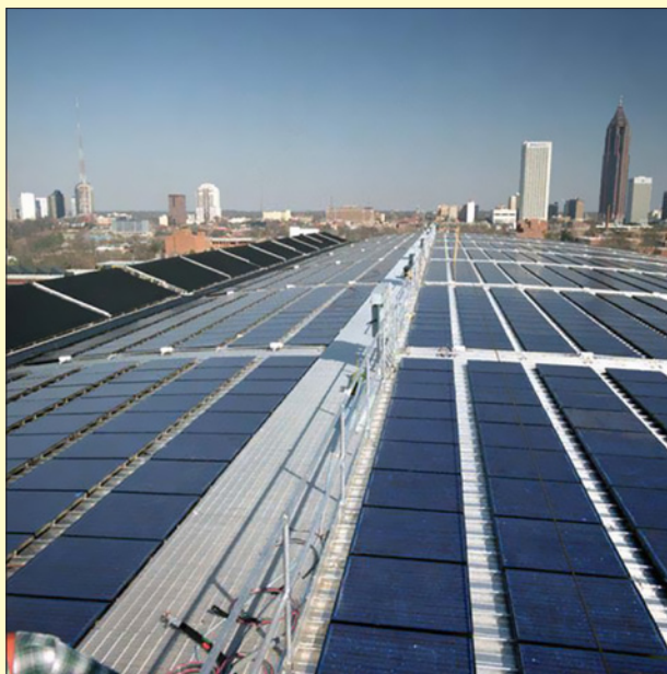
Obr. 1. Střešní instalace kombinovaných solárních panelů pro výrobu tepla a elektřiny v Atlantě (USA)
