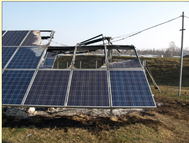
Obr. 2. Pohled na ohněm zničený fotovoltaický panel
