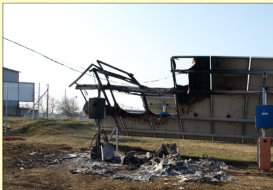
Obr. 3. Požárem poškozený fotovoltaický panel
