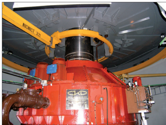
Obr. 7. Víko turbíny a dno elektrického generátoru (Dlouhé Stráně)
