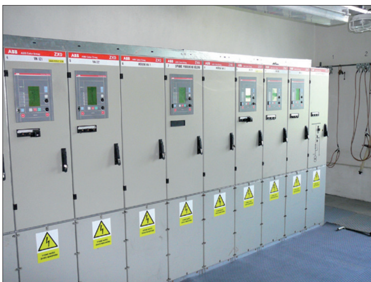
Obr. 5. Zapouzdřená rozvodna 22 kV
