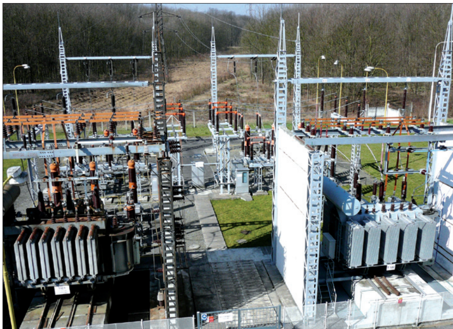
Obr. 1. Venkovní rozvodna 110 kV se dvěma stanovišti výkonových transformátorů
