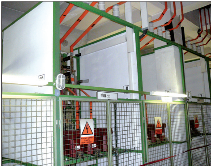
Obr. 3. Kobková rozvodna 22 kV
