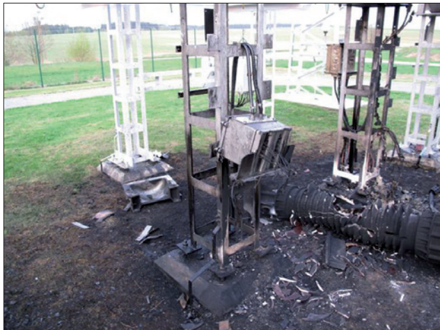
Obr. 6. Požár kombinovaného měřicího transformátoru v rozvodně 110 kV
