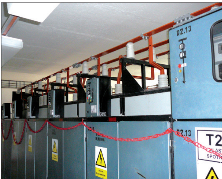
Obr. 4. Skříňová rozvodna 22 kV
