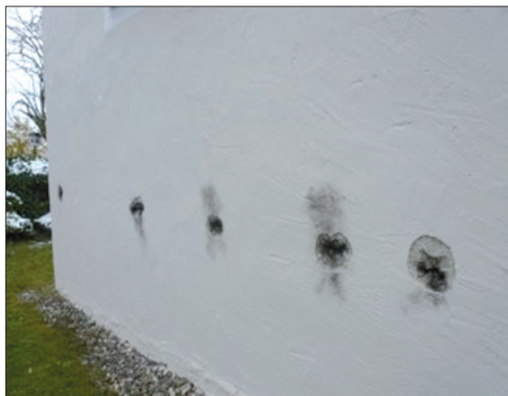
Obr. 6. Po úderu blesku do objektu došlo k vyrovnání potenciálů pomocí hydroizolace objektu
