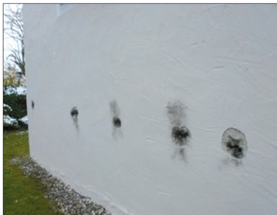
Obr. 6. Po úderu blesku do objektu došlo k vyrovnání potenciálů pomocí hydroizolace objektu
