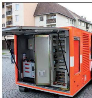
Vývodová pole řídicího prostoru elektrocentrály EC 250
