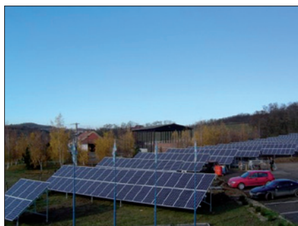
Obr. 3. Fotovoltaická elektrárna na volné ploše
