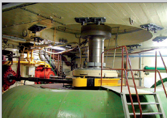
Obr. 5a. Za komorou s uzavíracími kulovými čepý jsou umístěny dvě Francisovy turbíny, každá o výkonu 60 MW
