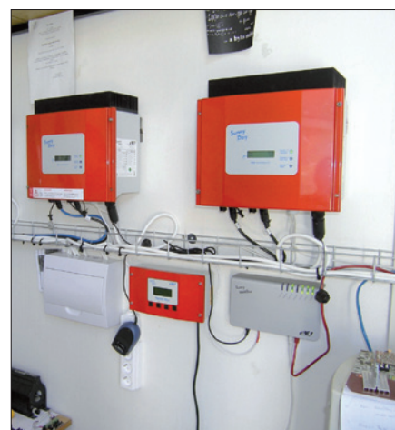
Obr. 2. Elektronický měnič s rozvodnou deskou a dataloggerem na stěně laboratoře
