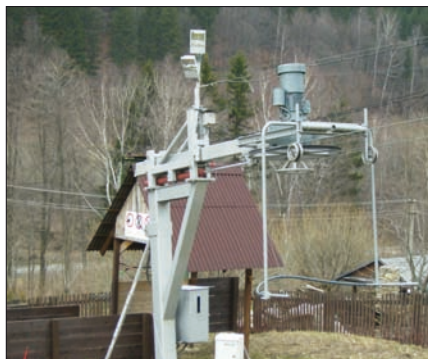
Obr. 3. Osvětlení poháněcí stanice lyžařského vleku svítidly PSS 400 W – Blahuta Elektro
