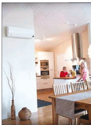
Obr. 1. Pohled s tepelným čerpadlem vzduch-vzduch (IVT Nordic Inverter – vnitřní jednotka)
