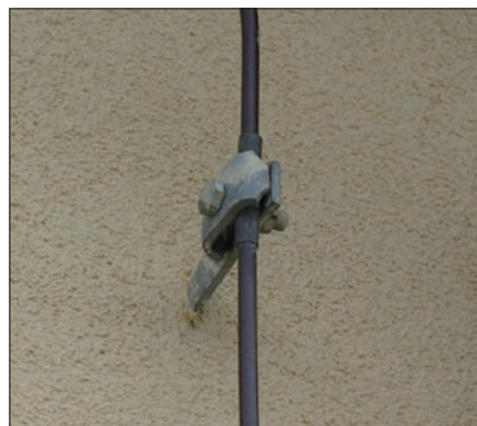
Obr. 6. Olověná vložka mezi pozinkovanou ocelí a mědí
