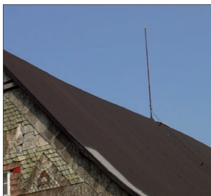
Obr. 1. Staré provedení jímací tyče
