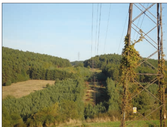
Obr. 2. Venkovní vedení pro přenos elektrické energie
