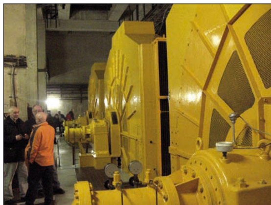
Obr. 5. Temně hučí... alternátory 1 890 kW
