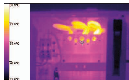
Obr. 4. Horká připojení v řídícím rozváděči
