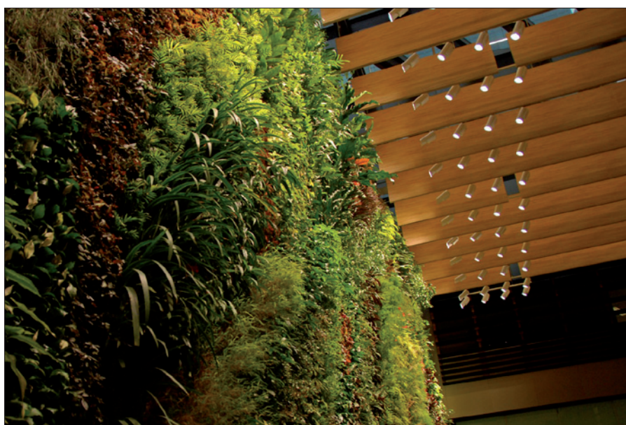
Obr. 2. Osvětlovací soustava vertikální zelené stěny s reflektory (Capita Land, Singapur)
