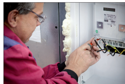
Obr. 2. PRE zajišťuje kompletní nabídku elektroinstalačních služeb
