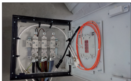
Obr. 1. Pohled do kombinovaného rozváděče s jedním prostorem pro zakončení elektrických a optických rozvodů
