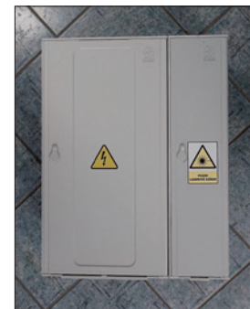
Obr. 2. Kombinovaný rozváděč se dvěma oddělenými prostory pro zakončení elektrických a optických rozvodů; každý prostor je uzavřen samostatnými dveřmi
