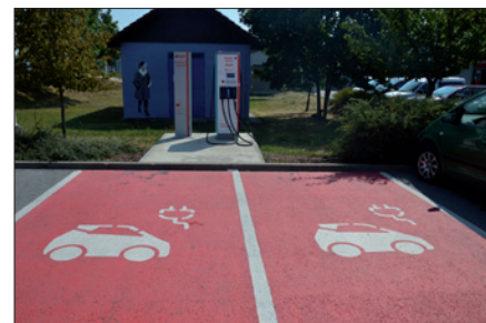
Obr. 3. Součástí dobíjecí stanice je i vyhrazené parkovací místo
