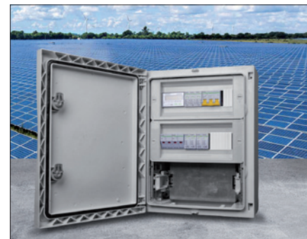
Obr. 4. Rozvodnice pro fotovoltaický panel
