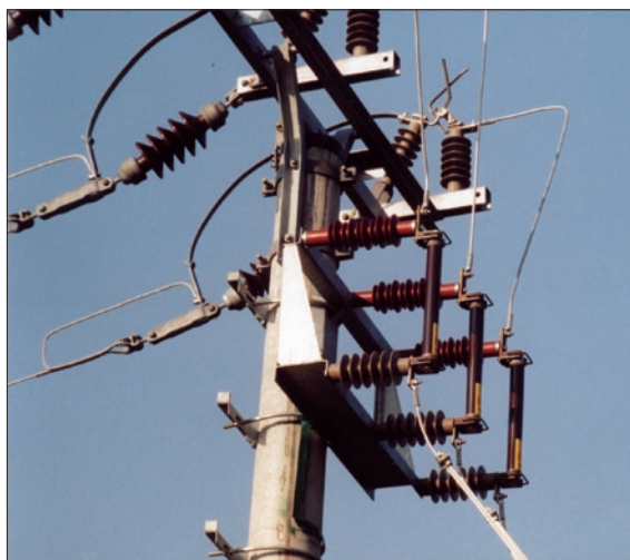
Obr. 1. Omezovače přepětí jako součást vybavení sloupové transformovny
