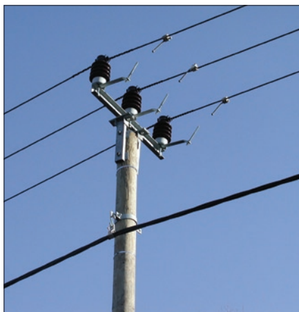
Obr. 4. Ochrana hrotovými jiskřišti na venkovním vedení s izolovanými vodiči
