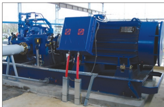
Obr. 6. Pohony s motorem 1 900 kW, 6 kV, 50 Hz (Y), resp. 3,46 kV, 0 až 55 Hz (D)
