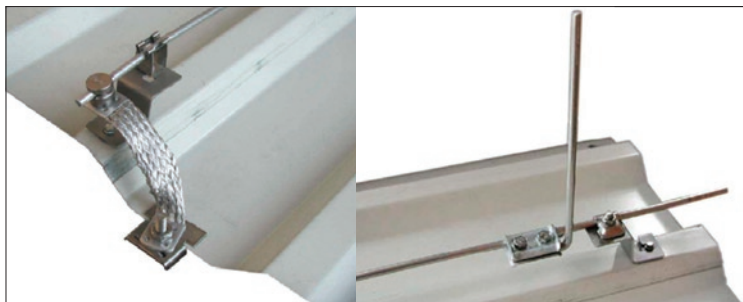
Obr. 9. Detail samoostatné jímací soustavy na kovové střeše
