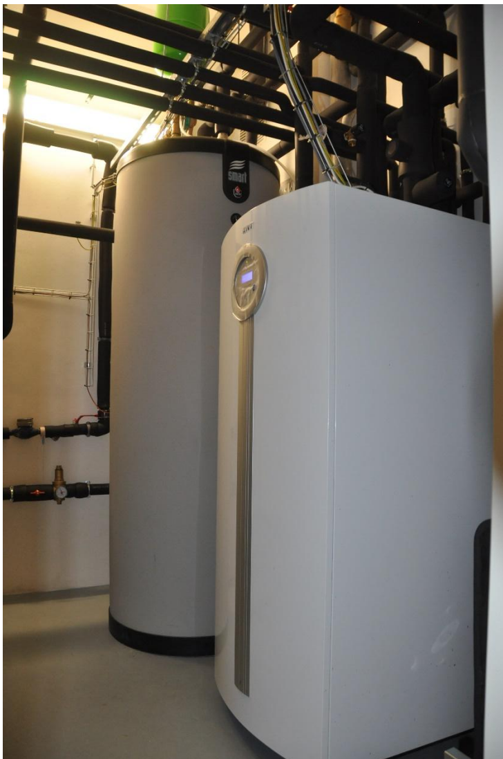
Teoelné čerpadlo, aku nádrže
