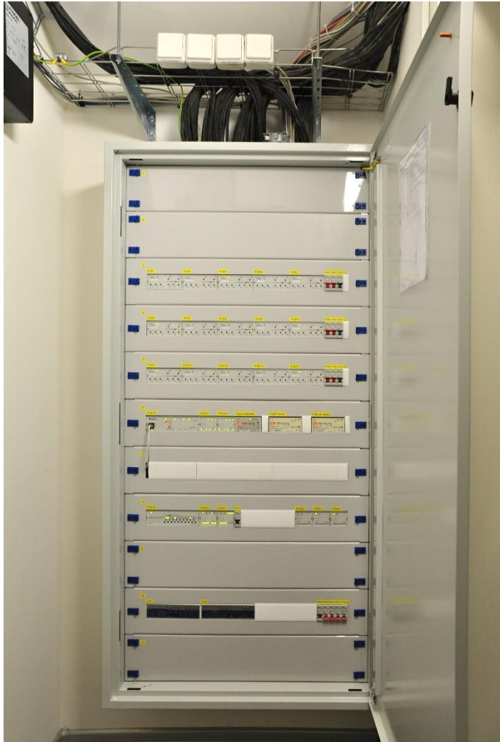
Zakrytovaný rozvaděč v RD
