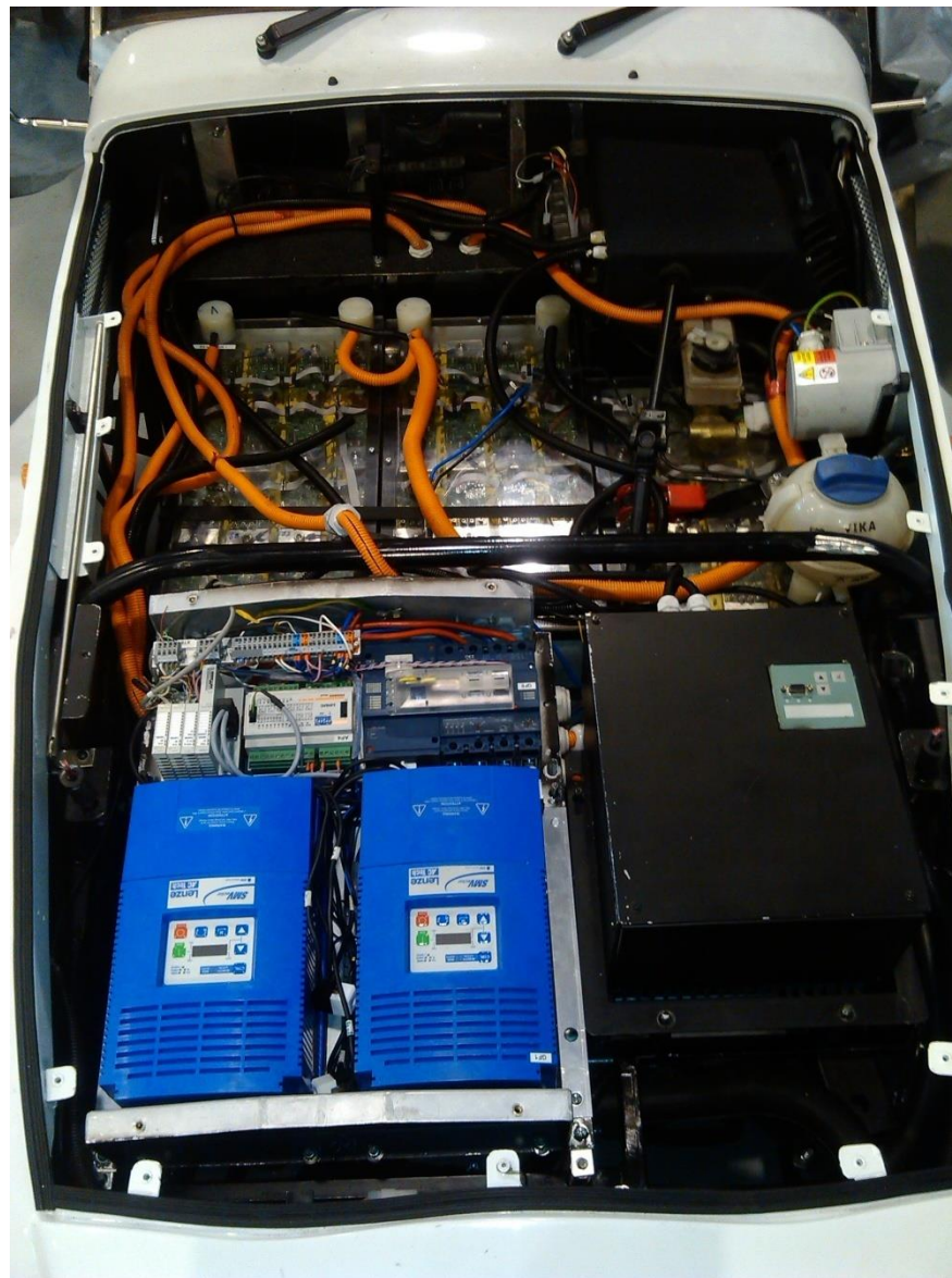
Obr. 35 Zástavba integrovaného nabíjecího systému do 120A (parametrizace Siemens SIMOREG, zastavěno v prototypu K2, 2011)
